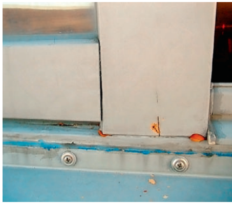
Wenn das Wasser sich einen Weg sucht: Hauptursache für Schäden ist die sogenannte Kapillarfuge.
