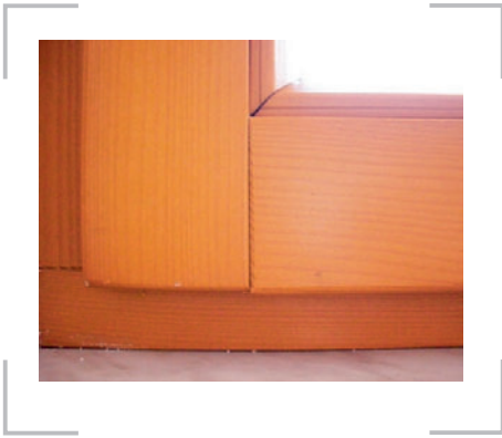
In diesem Fall handelt es sich um einen Verarbeitungsfehler (Foto: Holz-Bau-Technik Knaus)
